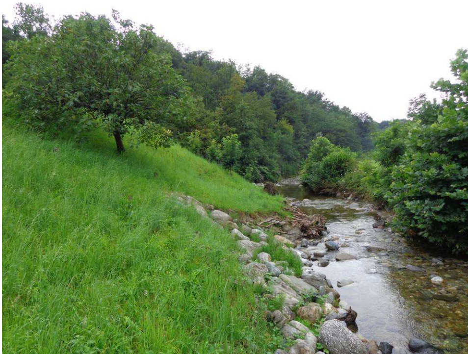
Figura 8 – Tratto della sponda idrografica sinistra del T. Cosia in corrispondenza della confluenza del Valletto Cantinera. Versante antropico in frana.
